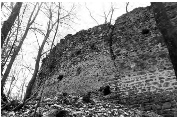
Сл. 7 Спољашње лице дела северног бедема Горњег града на утврђењу Јеринин град у Грабовцу код Трстеника (фото: Д. Радисављевић)
